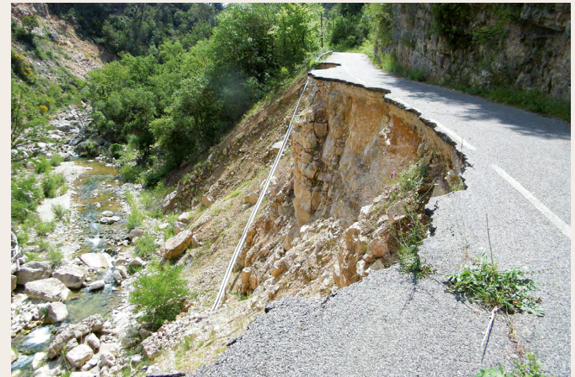
Effondrement de chaussée - © Cerema
