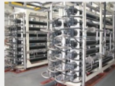
Appareil de nanofiltration (fonctionnant à l'électricité) pour épurer l'eau « potable » avant distribution.
