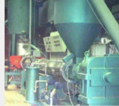
Extrudeuse de plastique (fonctionnant à l'électricité) pour fabriquer le tube dentifrice.
