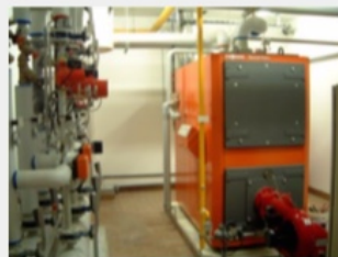
Chaudière (fonctionne au gaz ou au fioul).
